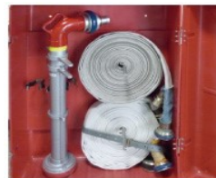
スタンドパイプとホース
