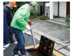
消火栓に差し込む
