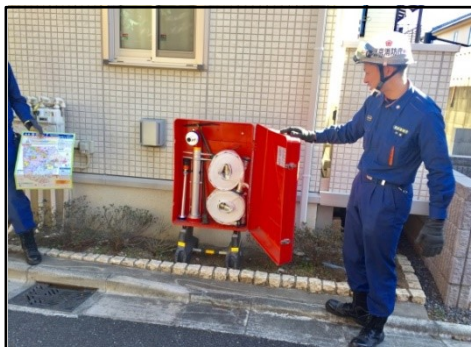
スタンドパイプ収納箱の中にはマンホールを開ける消火栓キーとスタンドパイプ、ホース4巻き、スピンドルドライバー、筒先が入っています。
