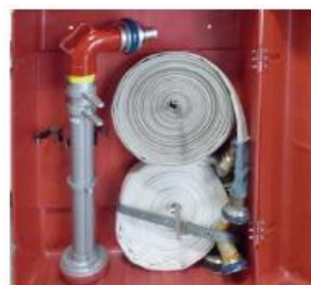
スタンドパイプとホース
