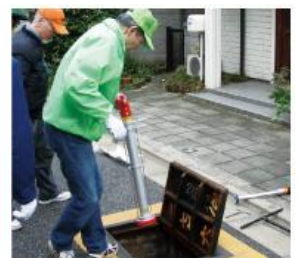
消火栓に差し込む
